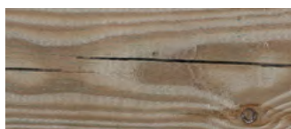
Fissures de contrainte provoquées par le séchage du bois
