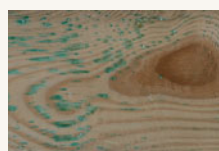
Efflorescences de sels d'imprégnation verdâtres
